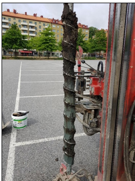
Figur 8 Provpunkt NC1820 med nästan svart fyllnadsmaterial med övergång till naturlig lera under. Denna jordskruv hade halter av PAH över riktvärden för MKM.
